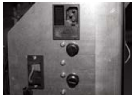
Fig. 33 - Termostati di sicurezza
